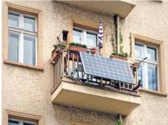
Typisches Beispiel für eine sinnvolle, von Vermietern aber häufig abgelehnte Modernisierung: das Balkonkraftwerk
